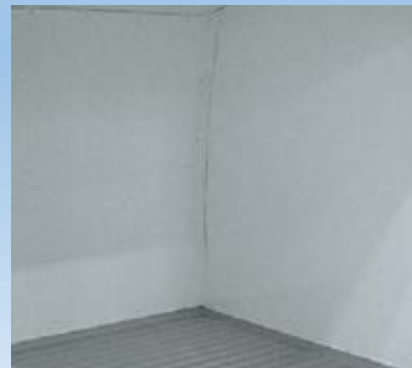
固定式間仕切り
