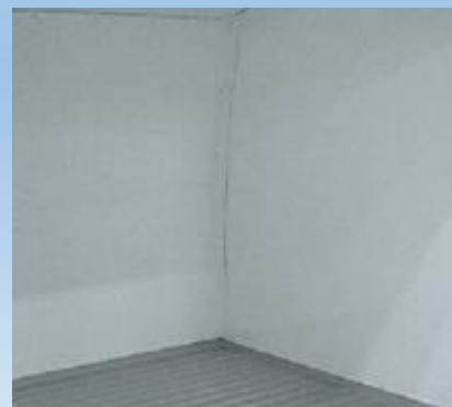
固定式間仕切り
