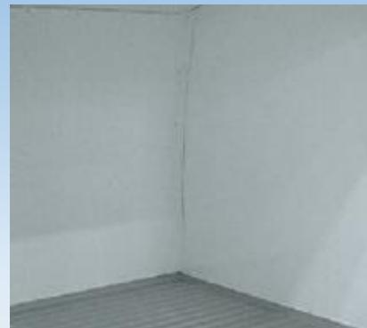
固定式間仕切り
